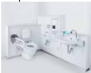
Le concept universel dans les installations publiques (Crédit photo : INAX)
